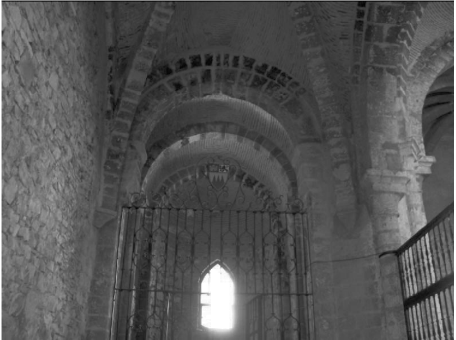
Figura 1. Estado actual de la capilla de Pedro Girón en la iglesia del Conventual de Calatrava la Nueva (Ciudad Real)
